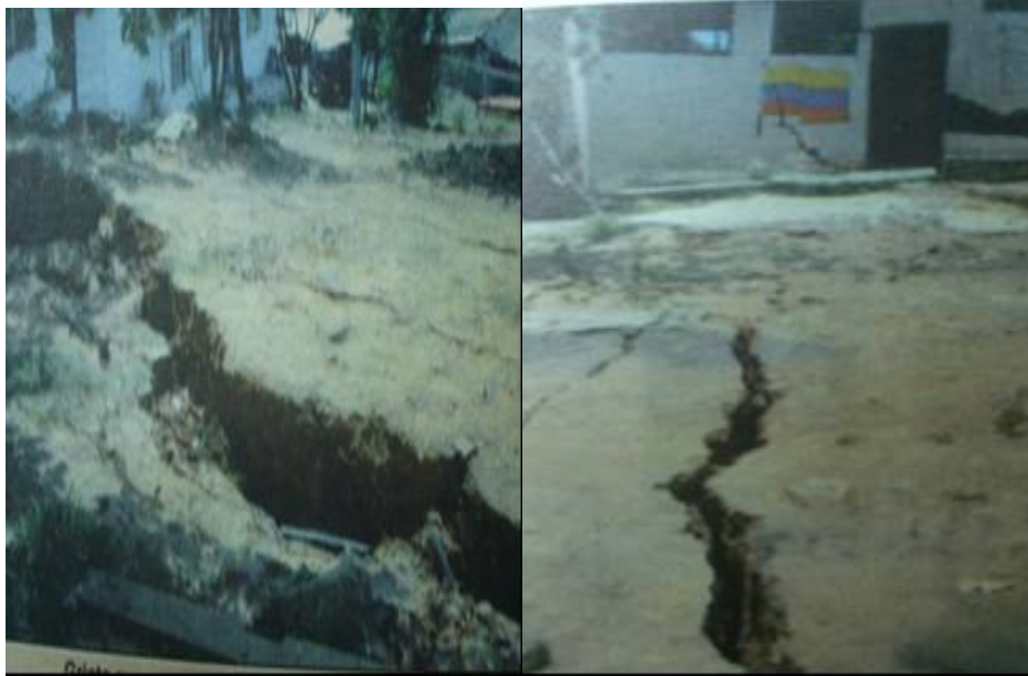
Foto 11 y 12. Las grietas que amenazaban al barrio Nuevo Horizonte, se constituyeron en un desastre para el año de 1998. Fuente periódico Yumbo esfuerzo de todos, 1997.
